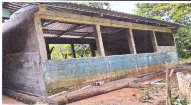
Foto 6: Se observa en la imagen que se añadio hilada de block para nivelar las paredes del establecimiento.
